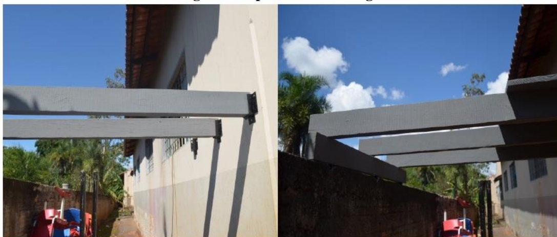
Figura 3. Suporte da caixa d'água.
