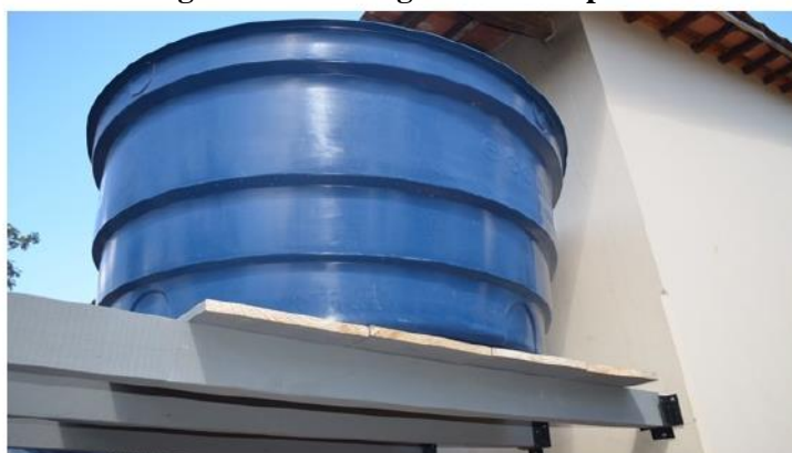
Figura 7. caixa d'água sobre o suporte.
